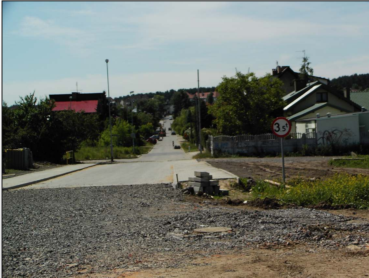
Usunięta zaporą i dobudowana droga od strony Dobrej – 2005 r. (4/10)
