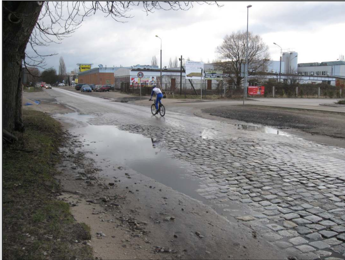
Ulica przed remontem (1/12)
