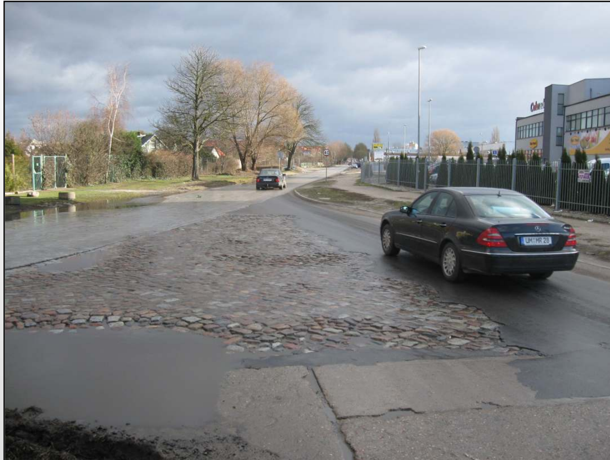
Ulica przed remontem (2/12)
