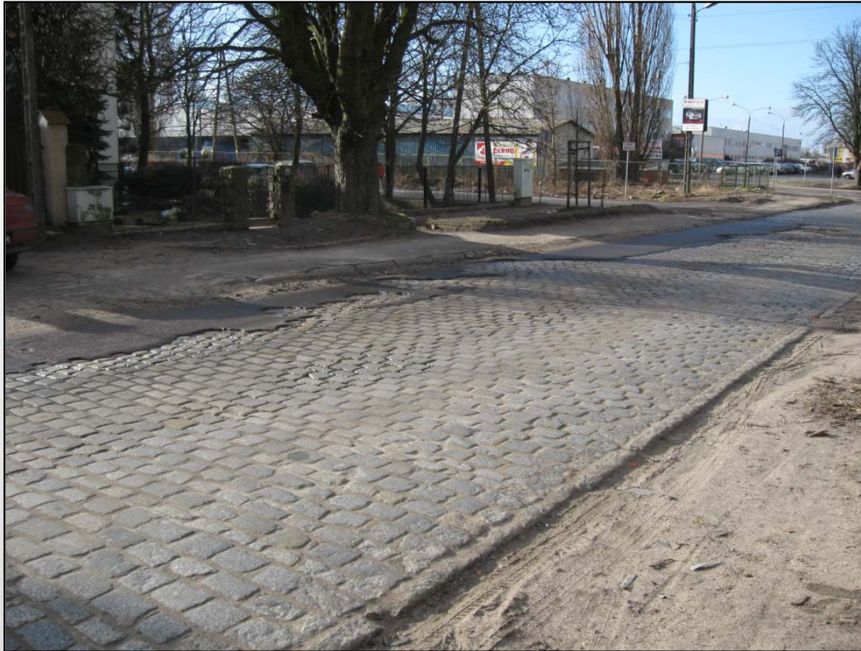
Ulica przed remontem (4/12)
