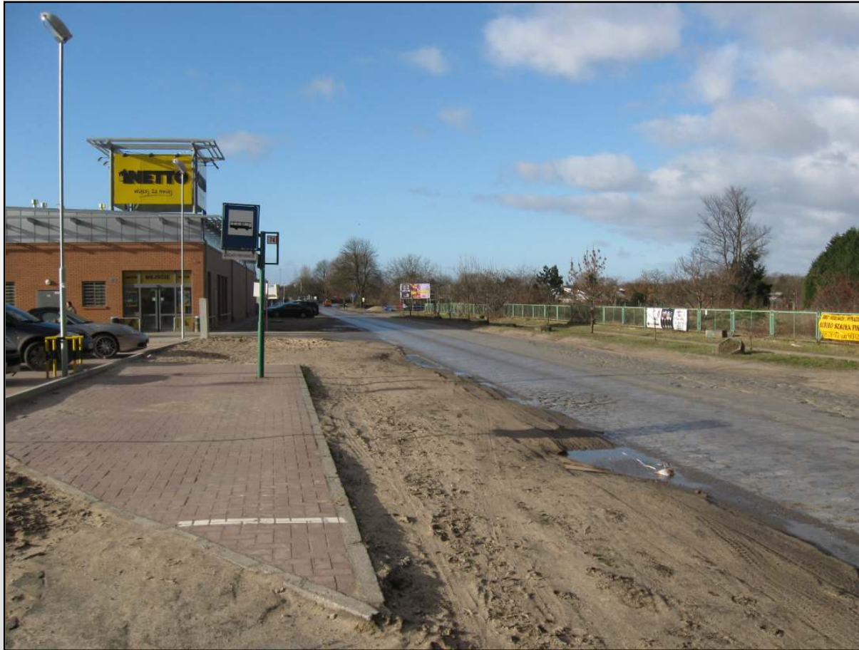
Ulica przed remontem (3/12)
